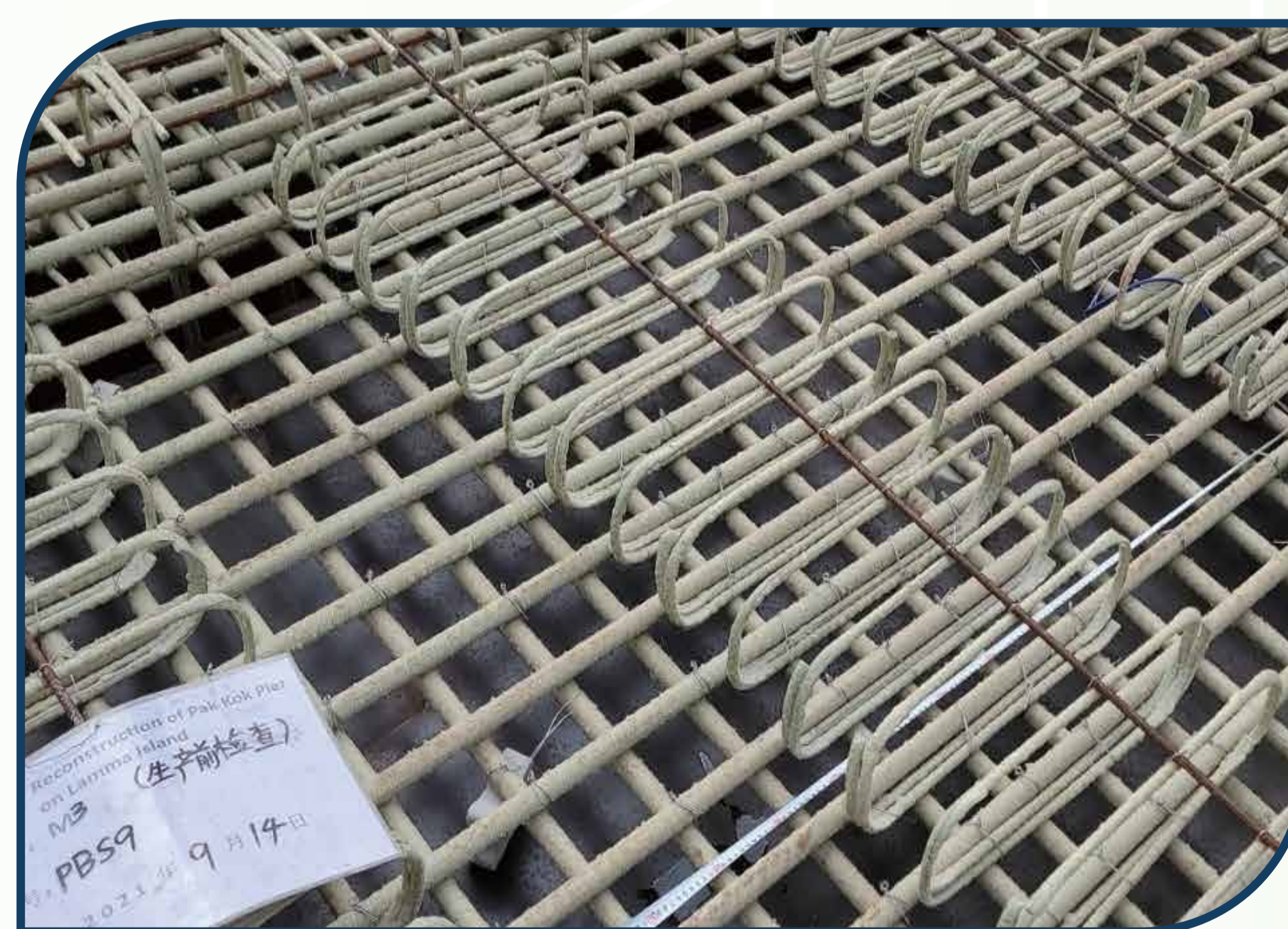
南丫島北角碼頭混凝土層板結構中的 玻璃纖維筋 GFRP Rebar in Concrete Slab of the Pak Kok Pier on Lamma Island
